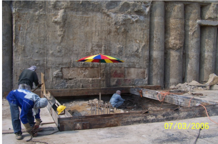
รูปที่ 6-9 งาน DIAPHRAGM WALL ที่จะทำงาน PIPE JACKING เป็นท่อเหล็กกระบายน้ำ เชื่อมต่อกับ ระบบโรงสูบน้ำใต้ดิน (SUMP PUMP TANK) บริเวณมุมสี่แยกเขต-พหล ฝั่งถนนเกษตร-นวมินทร์ขาออก
