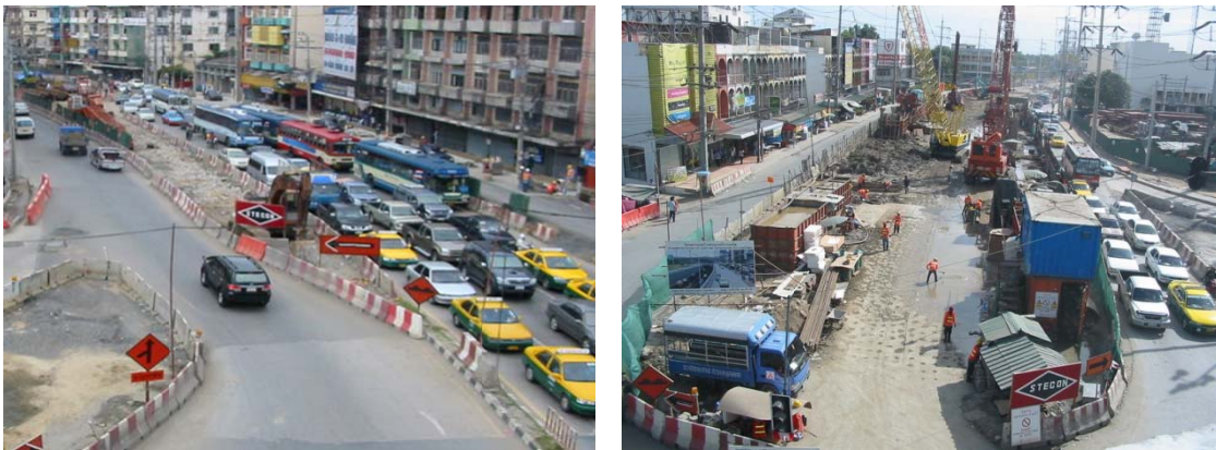
รูปที่ 8-2 ปัญหาการจราจรติดขัดเนื่องจากพื้นที่ก่อสร้าง
