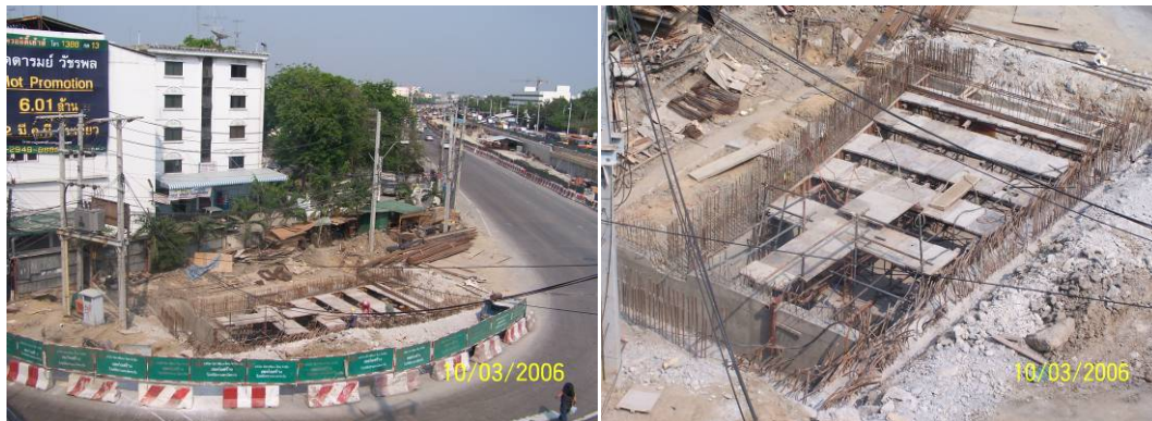
รูปที่ 6-10 งานก่อสร้างโรงสูบน้ำออกจากทางลอด (SUMP PUMP TANK AND CONTROL ROOM) บริเวณมุมสี่แยกเกษตร -พหล ฝั่งถนนเกษตร - นวมินทร์ขาออก
