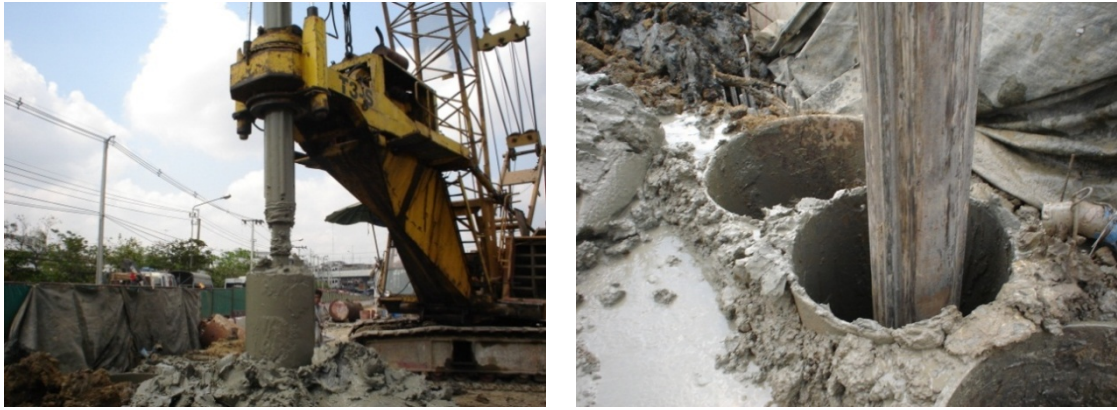
รูปที่ 3-41 การเจาะเสาเข็มสำหรับก่อสร้าง Tangent Pile Wall
