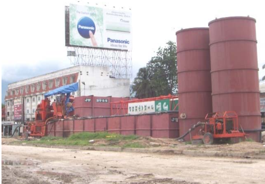
รูปที่ 3-33 ชุดติดตั้ง Recycle Bentonite Slurry
