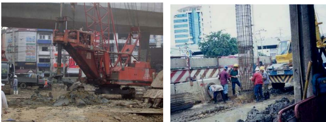
รูปที่ 4-4 เสาเข็มเจาะสำหรับโครงสร้าง Base Slab
