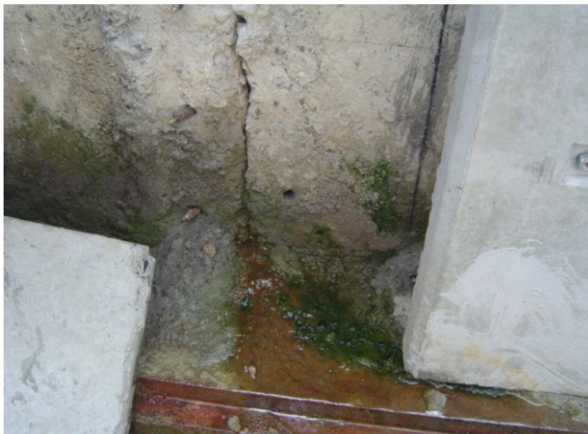
รูปที่ 3-37 ตัวอย่างการรั่วซึมบริเวณรอยต่อแผงคอนกรีตผนังพีต
