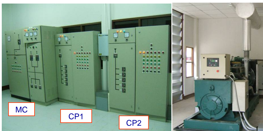
รูปที่ 6-8 ส่วนควบคุมระบบ Pump และ ส่วนควบคุมเครื่อง Generator
