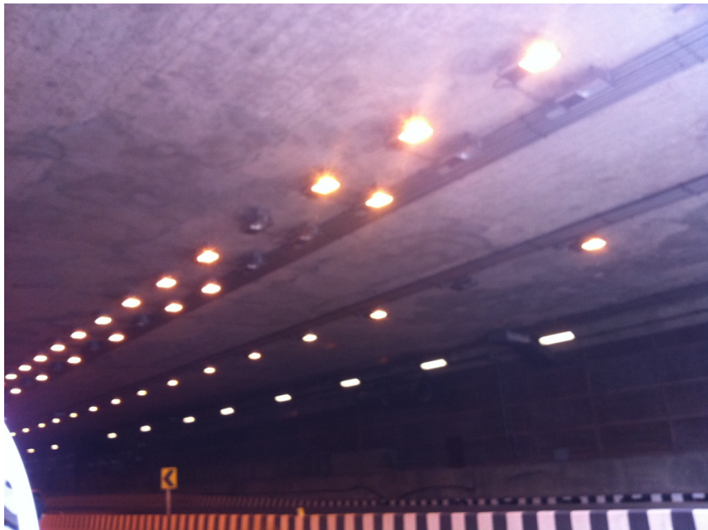
รูปที่ 6-13 ไฟฟ้าส่องสว่างภายในทางลอดขอนแก่น ที่มีการปรับแสงบริเวณปากทางเข้าออกให้สัมพันธ์กับแสงสว่างภายนอก
