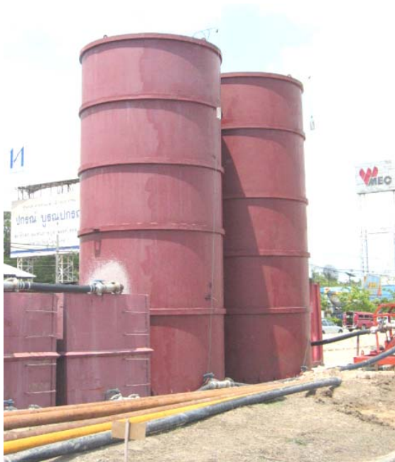
รูปที่ 3-15 ถังเก็บสารละลายพองเสถียรภาพ
