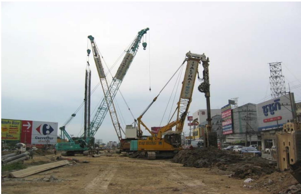
รูปที่ 3-24 เครื่องจักรที่ใช้ในการขุดดิน
